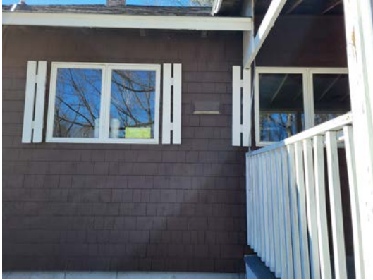
Stove exhaust fan outlet
